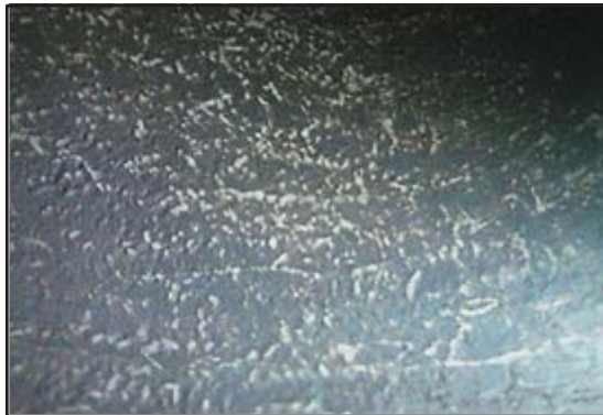
Superficie interna del tanque corroída.
